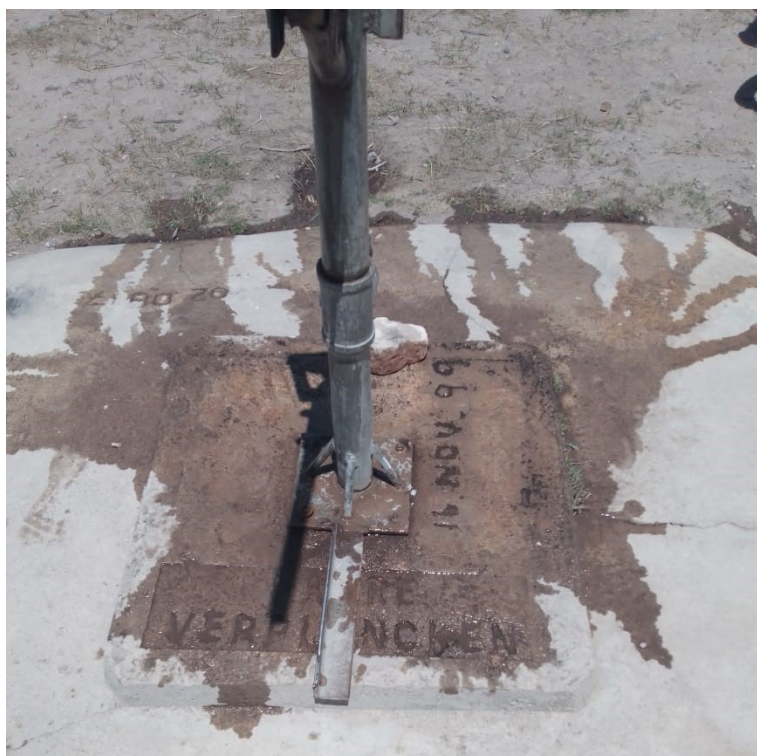
Fotografía 9. Estado actual de pozo construido como parte del proyecto impulsado por el P. Luis Verplancken, localizado en el ejido San Ignacio de Arareko. Ricardo Rodríguez, mayo de 2021.
